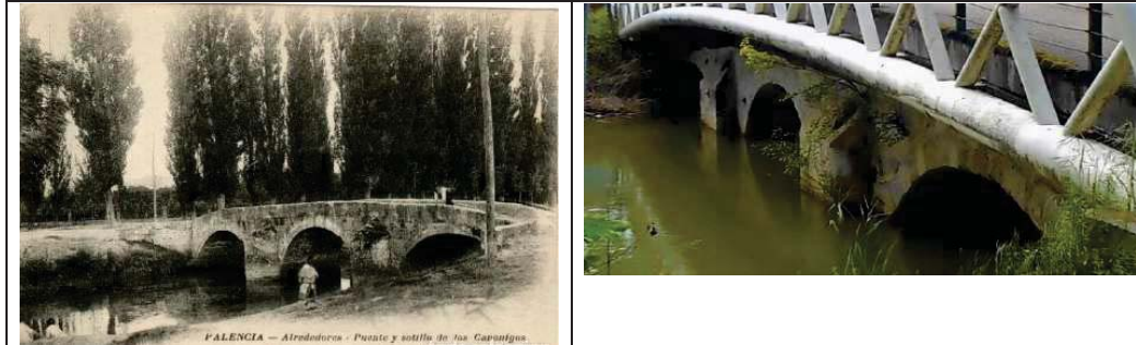
Vista General del puente de los Canónigos, desde la margen derecha. Sobre él se realizó una desafortunada intervención que enmascara por completo el puente original.
