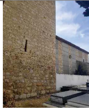
Torre de la Parroquia ubicada al norte de la cabecera de la iglesia.
