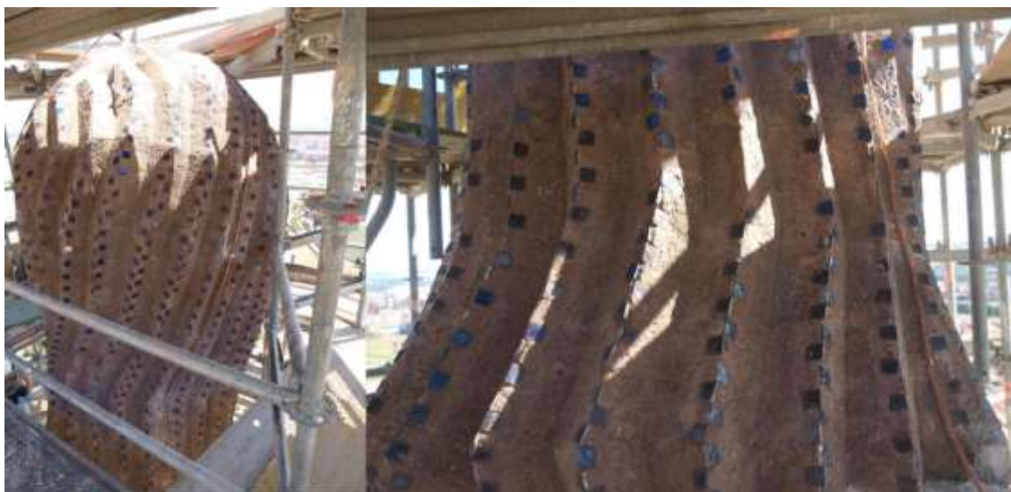
Figura 47. Vistas de la cabeza desde atrás, donde vemos el gresite de tonos azules, de producción industrial, que da todo al cabello, y refuerza los cantos de los relieves de la escultura. Foto: Memoria del proyecto de restauración de Valuarte, 2017 © Valuarte
